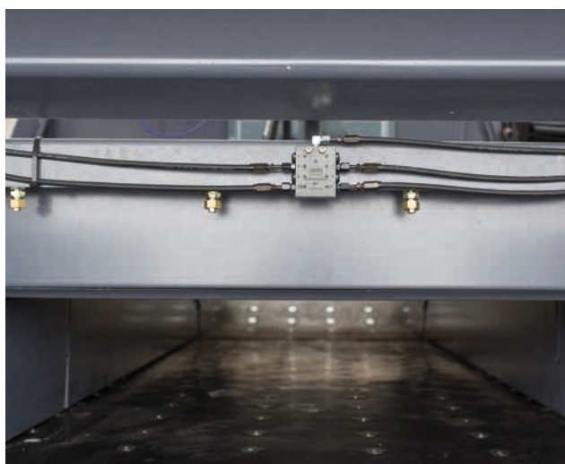
Propre d'une simple pression sur un bouton : l'installation de nettoyage du convoyeur.
